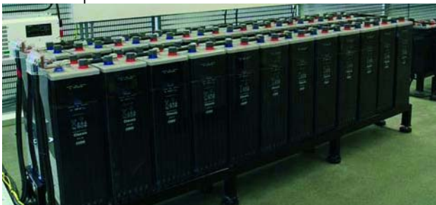
Figura 39. Baterías electroquímicas. Cortesía de LABEIN-TECNALIA.
