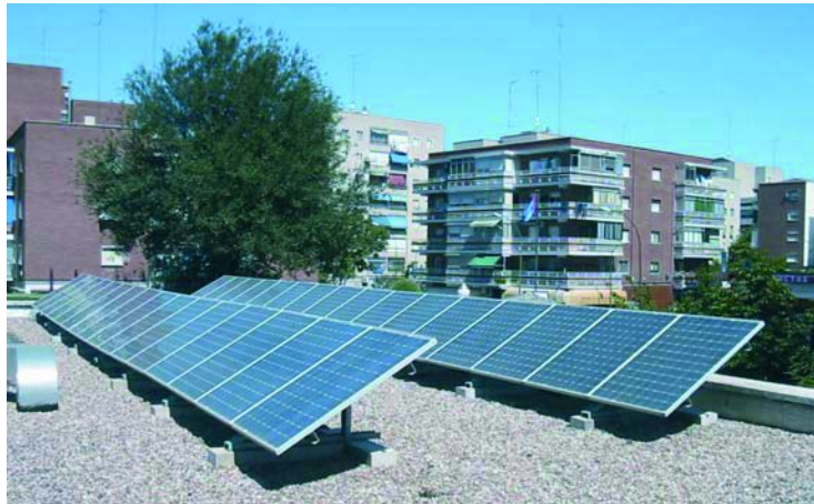
Figura 20. Paneles fotovoltaicos sobre edificios municipales en Mostoles.
