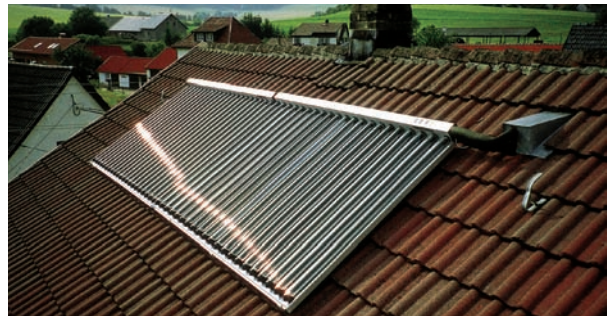
Fig. 52: Ejemplos de instalaciones – Colector de tubos de vacío
