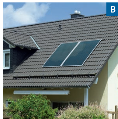
B Calentamiento solar del agua potable
