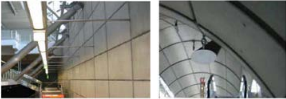
Figura 4.5. Diferentes sujeciones de luminarias en el Metro.
