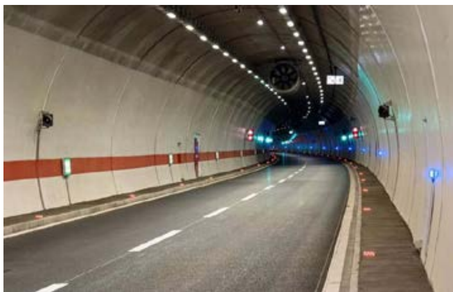
Figura 1.1. Túnel con iluminación LED en Bosnia-Herzegovina. Fuente: Schröder.
