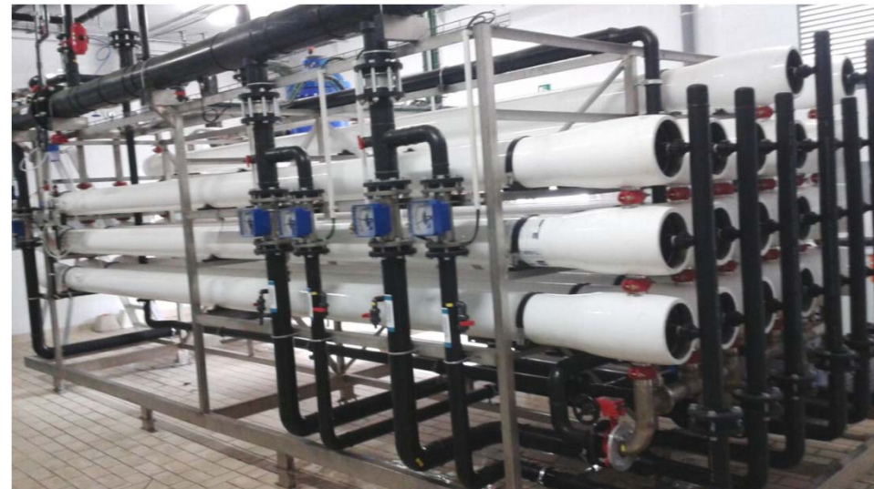
Planta de ósmosis
